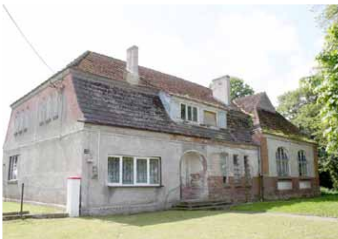
Budynek obecnej świetlicy - w stanie katastrofalnym
