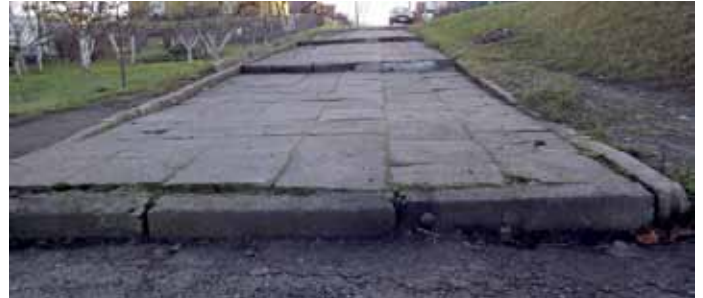
Schody ul. Kilinskiego przed remontem
